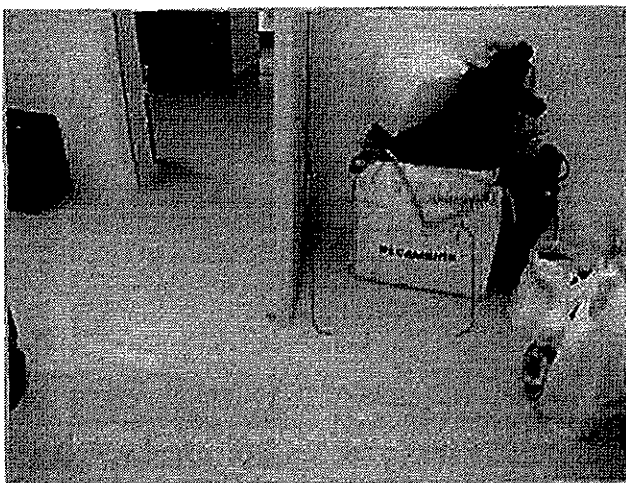
Fotografía N° 20: Falta de tope puerta.
