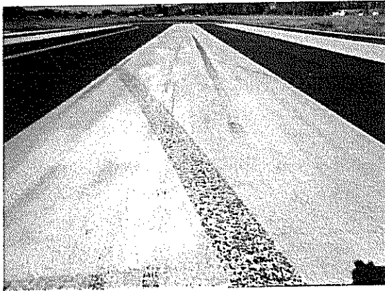
Fotografía N°75 de 28/03/2012: Aeródromo Los Confines de Angol. Falta de uniformidad en la demarcación de señales de umbral de pista.
