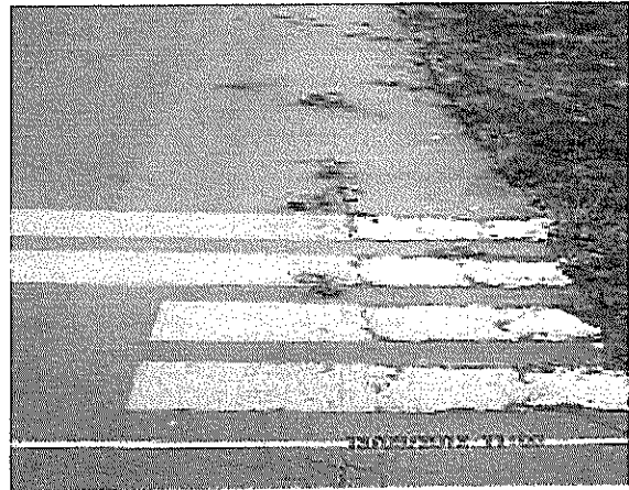
Fotografía N°14 de 13/03/2012: Ancho de calle de rodaje A insuficiente.
