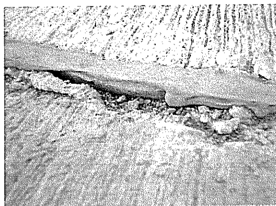
Fotografía N°46 de 08/03/2012: Aeródromo Cañal Bajo. Material sellante al descubierto.
