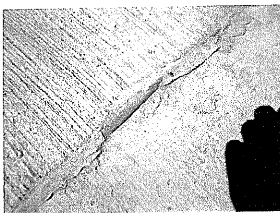
Fotografía N°47 de 08/03/2012: Aeródromo Cañal Bajo. Material sellante al descubierto.
