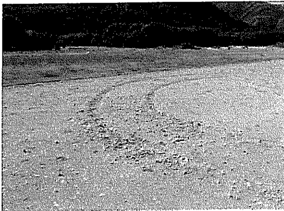
Fotografía N°17 de 14/03/2012: Aeródromo Lago Verde. Irregularidades en superficie de pista.
