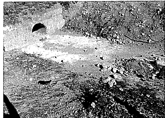
Fotografía N°18 de 09/03/2012: Aeródromo Teniente Vidal. Escombros y basura.
