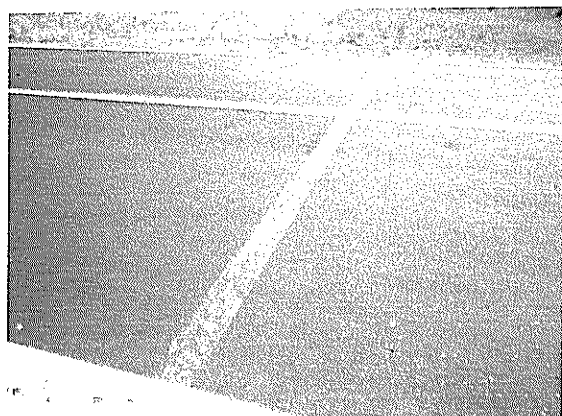
Fotografía N°129 de 28/03/2012: Aeródromo Los Confines de Angol. Señal de punto de espera de acceso a la pista no cumple con el Reglamento de Aeródromos.
