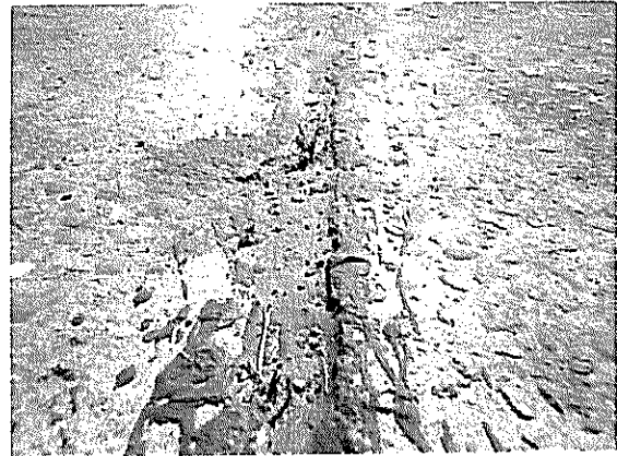
Fotografía N°56 de 28/03/2012: Aeródromo de Angol. Incrustación de piedras y arena en losa de prueba de motores.
