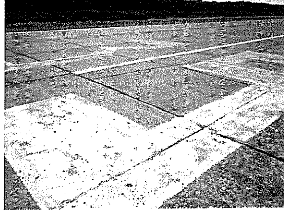
Fotografía N°14 de 05/03/2012: Aeródromo de Pupelde. Falta de uniformidad y cubrimiento de pintura en señal designadora de pista.
