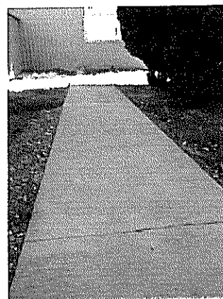
Fotografía N°18 de 26/03/2012: Aeródromo de Maquehue. Área Servicio de Extinción de Incendios. Vereda peatonal no ejecutada en pastelones de 50 x 50 centímetros.
