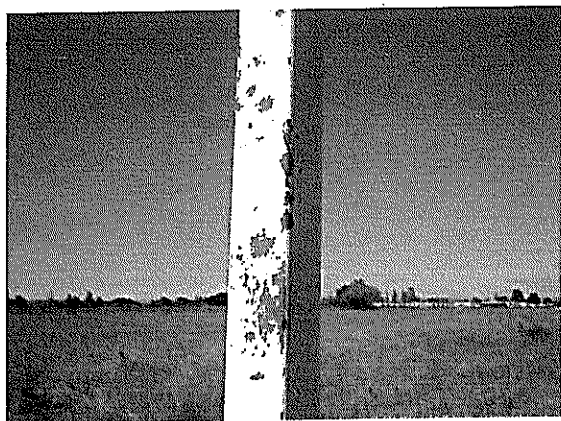
Fotografía N°123 de 28/03/2012: Aeródromo Los Confines de Angol. Cataviento oriente. Pintura descascarada en mástil metálico.
