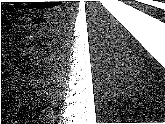
Fotografías N°85 de 29/03/2012: Aeródromo Villa Portales. Falta de cubrimiento y uniformidad en señales de borde de pista.
