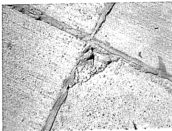
Fotografía N°53 de 08/03/2012: Aeródromo Cañal Bajo. Sector SEI. Grietas en cercanías de sellos de junta.
