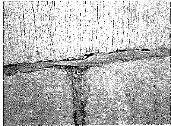
Fotografía N°50 de 08/03/2012: Aeródromo Cañal Bajo. Presencia de piedras y arena en caja de sello.
