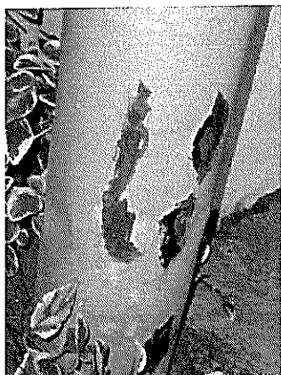
Fotografía N°13 de 26/03/2012: Maquehue. Bajada de aguas lluvias de la marquesina de acceso al aeropuerto.
