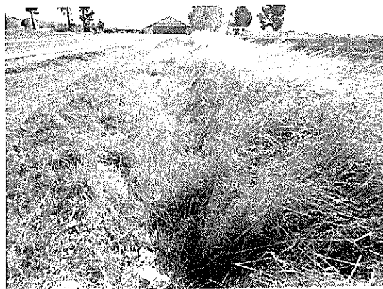
Fotografía N°112 de 28/03/2012: Aeródromo de Traiguén. Falta de limpieza en fosos de evacuación de aguas lluvias paralelo a calle de rodaje y pista
