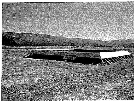
Fotografía N°130 de 28/03/2012: Aeródromo Los Confines de Angol. Fosa de 3 metros de profundidad dentro de la franja de seguridad de la pista.
