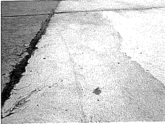
Fotografías N°55 de 28/03/2012: Aeródromo de Angol. Deficiencias en el acabado superficial de la losa de hormigón.
