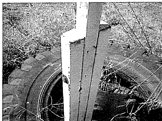
Fotografía N°122 de 28/03/2012: Angol. Cataviento oriente. Presencia de óxido en mástil metálico y pernos de sujeción.
